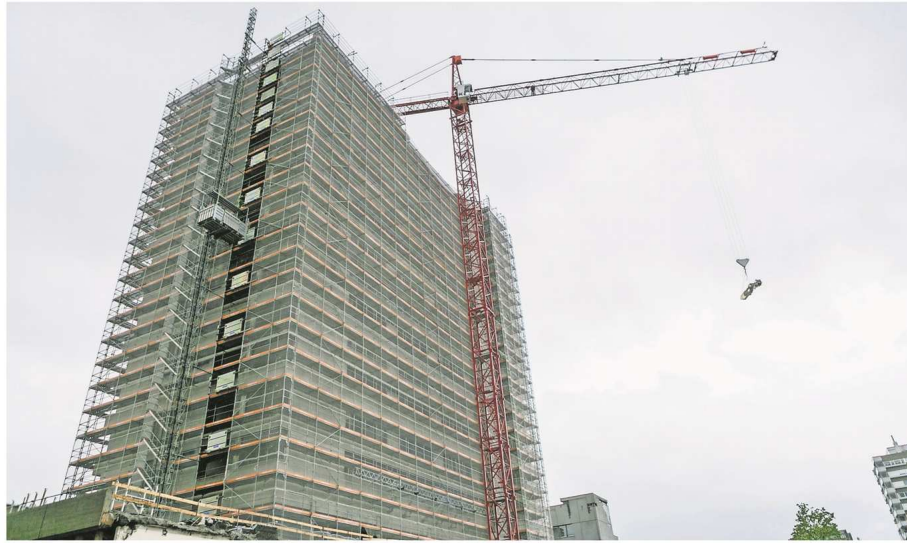
Noch steht das alte Akut-Spital in seiner ganzen Grösse: Doch mit dem Bagger, der in Einzelteilen aufs Dach gehievt wurde, beginnt nun der Abbruch.
